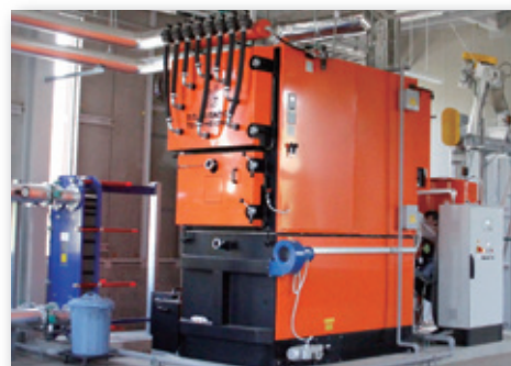
(バイオマスボイラー)
